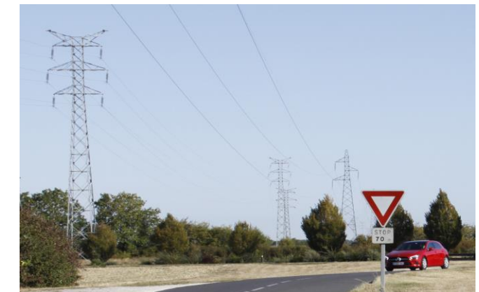
la ligne HT bordant l'A77 à Pannes
